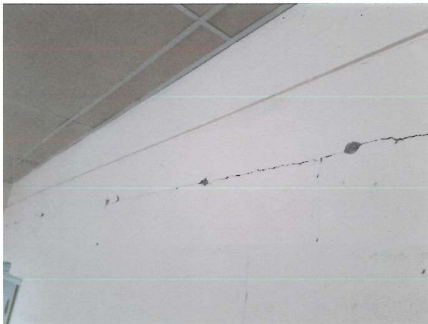
Sector y Observación: pared que divide oficinas de vestuario y pasillo 1er piso, se ve una importante fisura en estructura de block
