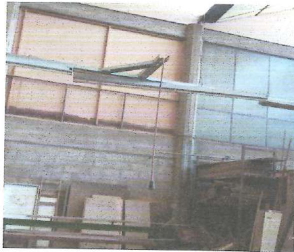
Sector y Observación: Taller de carpintería, se puede observar desplazamiento de luminaria (tubo fluorescente)
