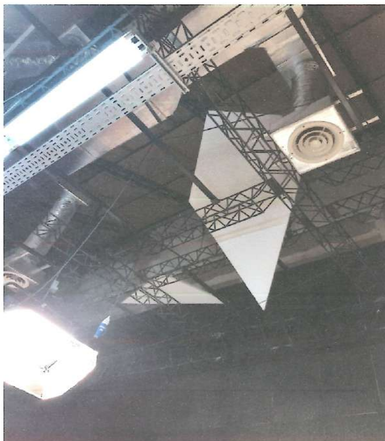
Sector y Observación: Estudio de grabación, se observa desprendimiento de partes del cielo raso
