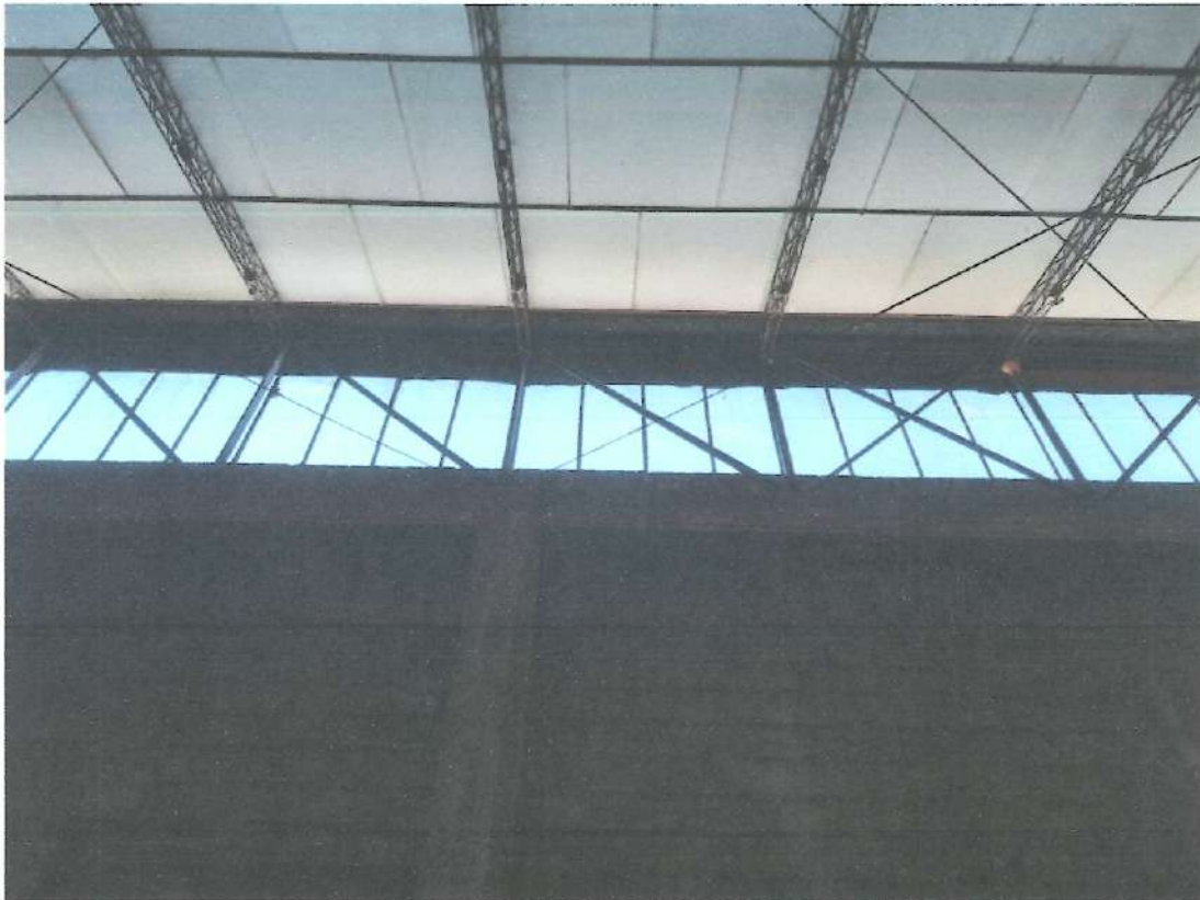
Sector y Observación: Paños vidriados en viga de techo sur, se puede observar trisaduras en varios vidrios del paño.
