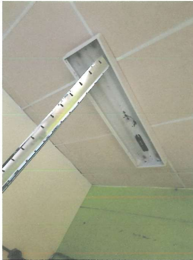
Sector y Observación: sector de vestuarios, desprendimiento de luminaria
